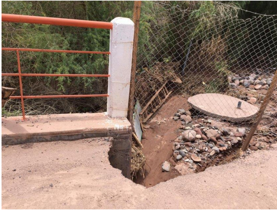
FOTOGRAFÍA 2-8: DAÑOS SOBRE LA INFRAESTRUCTURA
