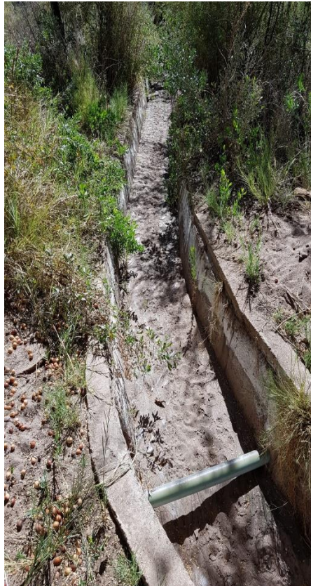
Fotografía N° 4-19: Canal Embancado en Cucuter
