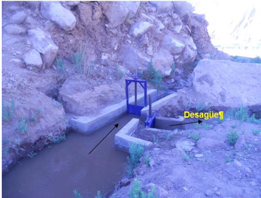
FIGURA 3.2.4.2-1 CANAL PATILLA COMPUERTA DE DESAGÜE AL RÍO
