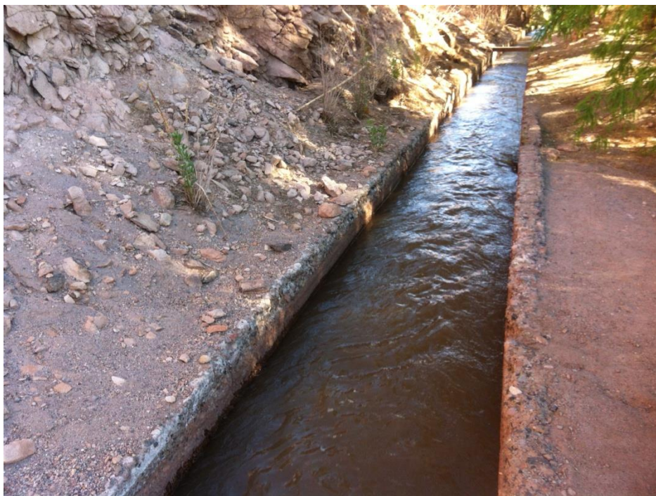
FIGURA 3.2.5.1-1 PROBLEMA PUNTO 1 CANAL SAN PEDRO
